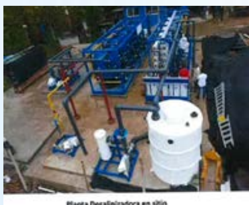
Planta Desalinizadora en sitio
