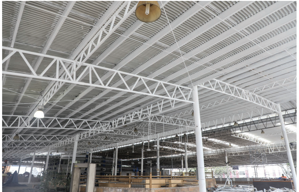
En la Plaza Víctor Julio Gutiérrez, se ha reemplazado todo el techo por uno nuevo con láminas termopaneles.
