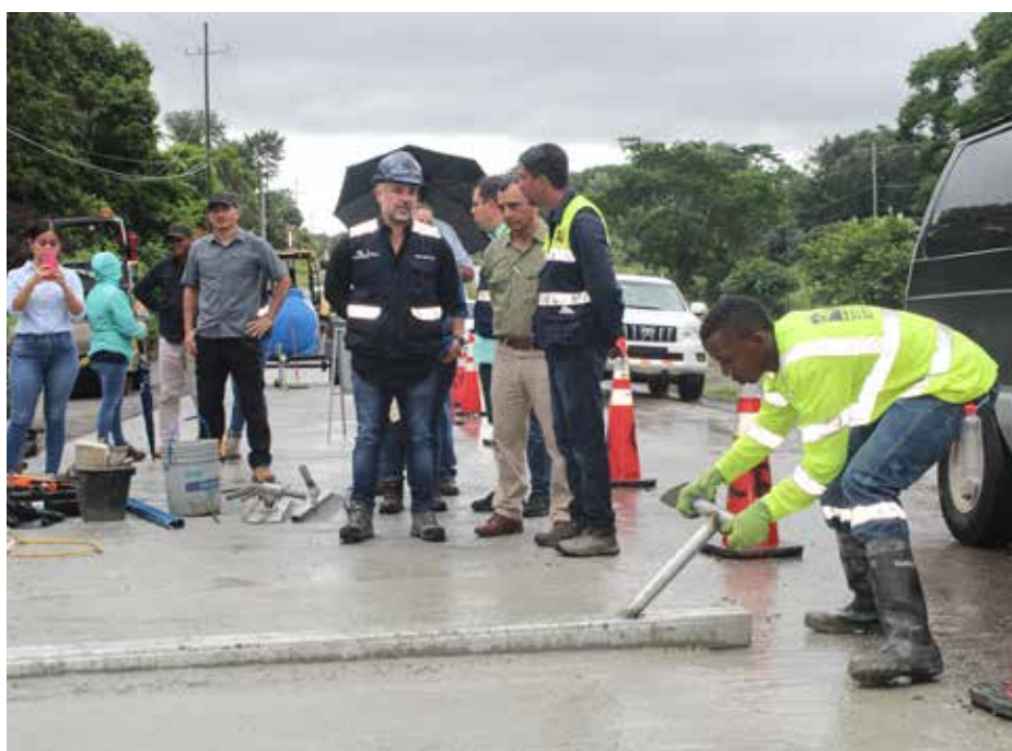
Labores de remoción y reposición de losa de concreto en los predios del puente sobre el río Capira.
